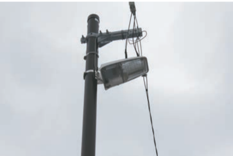
平成26年度一般会計補正予算のLED防犯灯賃貸借事業（全防犯灯のLED化を10年の賃貸借契約で進めます）
